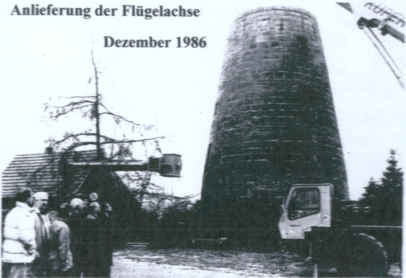
Der Spezialkran hat die 3,75 Tonnen schwere Hauptwelle am Haken; links der mit der Restaurierung beschäftigte Personenkreis.
